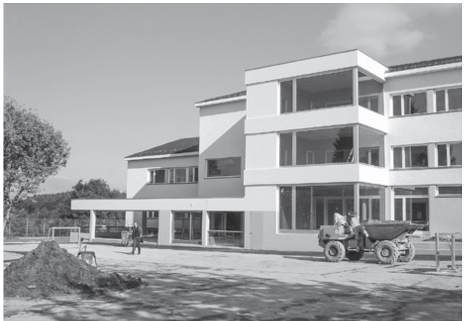
Der Anbau an das Schulhaus Blattenacher mit Gruppenräumen und einem Lift für die Erschliessung aller Stockwerke kurz vor der Fertigstellung im Jahr 2005.
