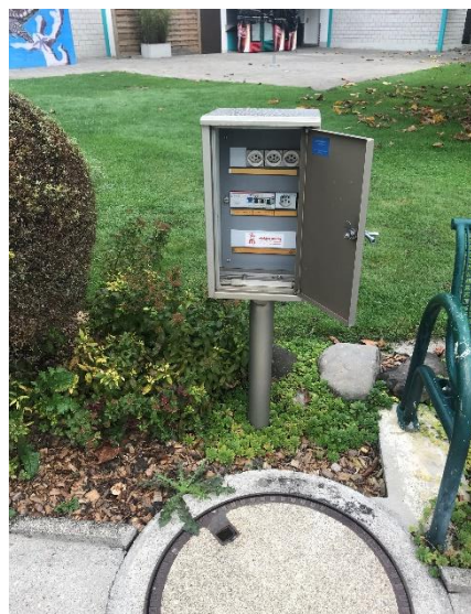
Abbildung 52: Steckdosenverteiler im Aussenbereich
