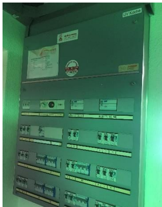
Abbildung 38: Unterverteilung Kiosk / Küche
