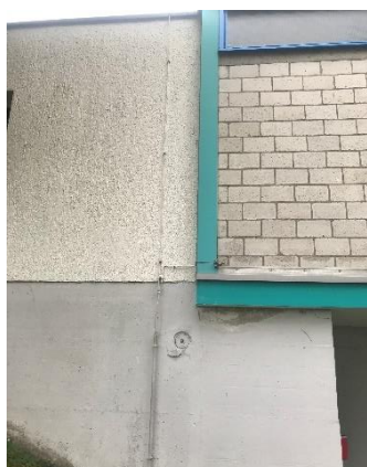
Abbildung 42: Blitzschutz mit Anschlussstelle
