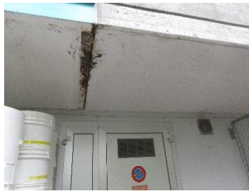
Abbildung 4: Undichte Dilationsfuge AGB und korrodierter Stahlträger
