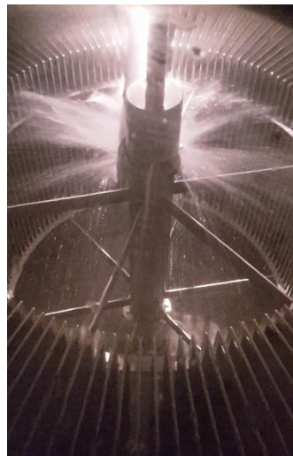
Abbildung 24: Filterplatten DASF bei der Rückspülung Bergholz (HBT, 2016)
