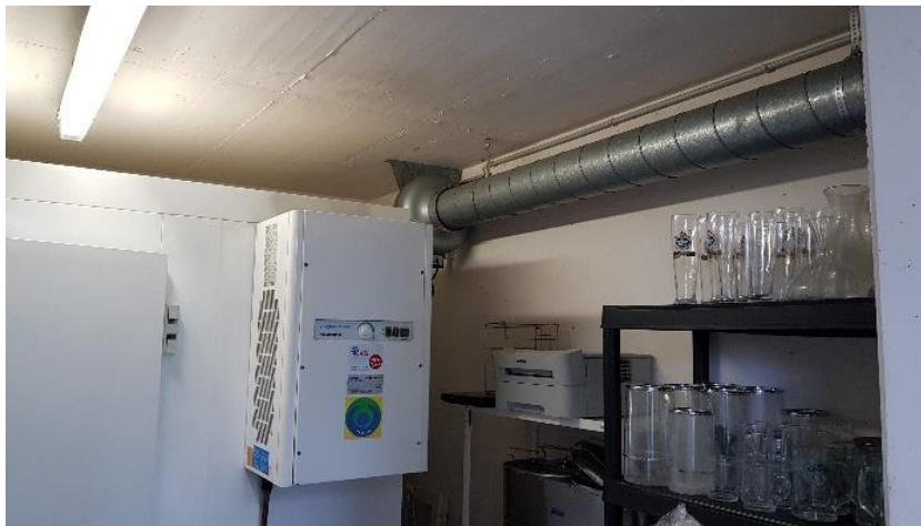
Abbildung 21: Lagerraum mit integriertem Kühlraum
