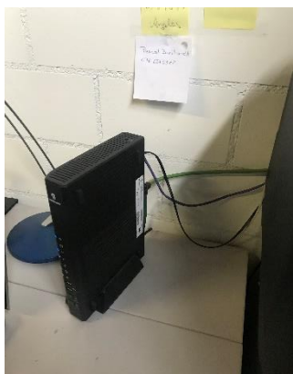
Abbildung 57: Swisscom Router in der Bademeisterloge
